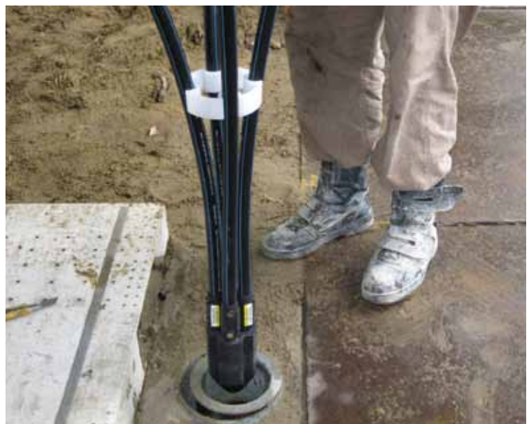
分岐管方式の地中熱交換器
